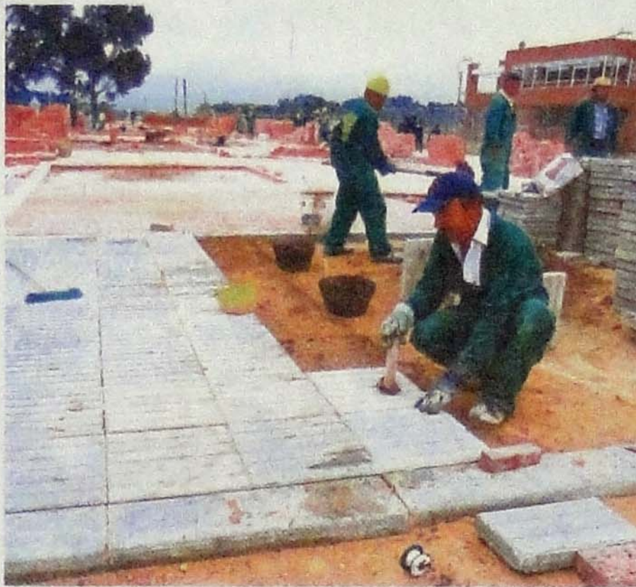
Los cobros de 'Obra por tu lugar' no serán obligatorios. A. PARTICULAR
